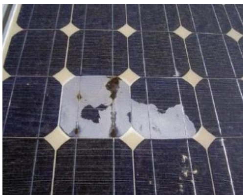
图3 光伏组件脱层
