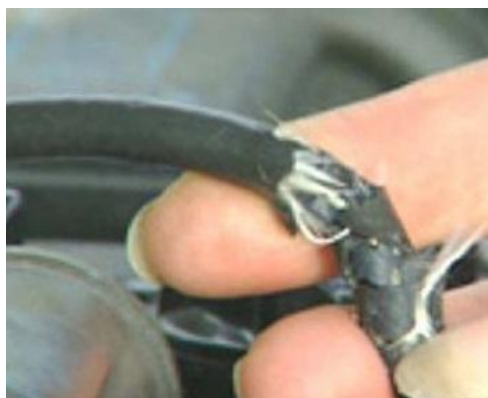
图4 光伏电缆破裂
