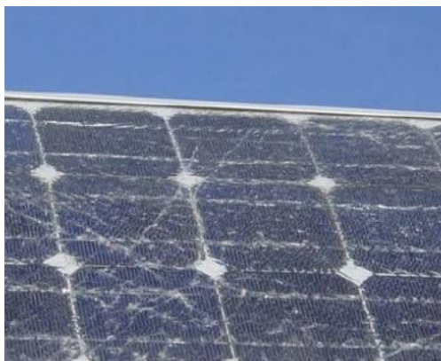
图1 光伏组件玻璃破裂
